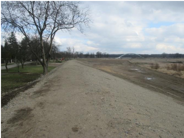
Obr. 4: Selská hráz v obecní části Miřejovice po rekonstrukci (11/2015); v pozadí potrubní most
