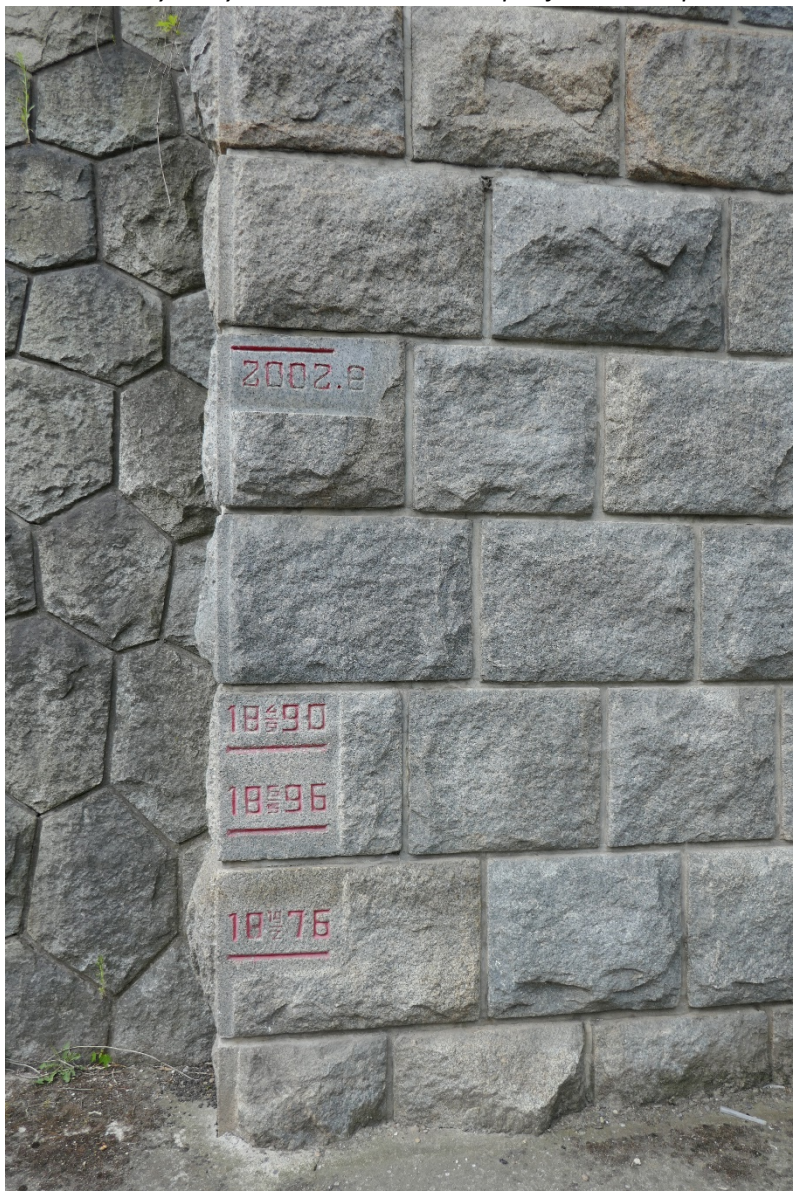
Značky velkých vod na železničním podjezdu ve Vepřku
