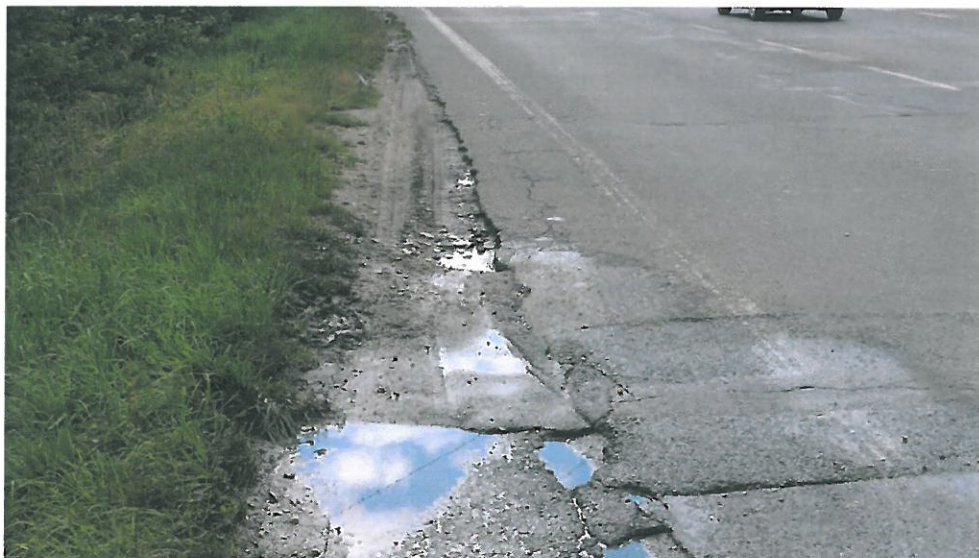
Opravované příčné trhliny vč. poškozené krajnice
