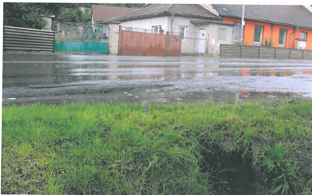
Poškození silničního tělesa dešťovou vodou
