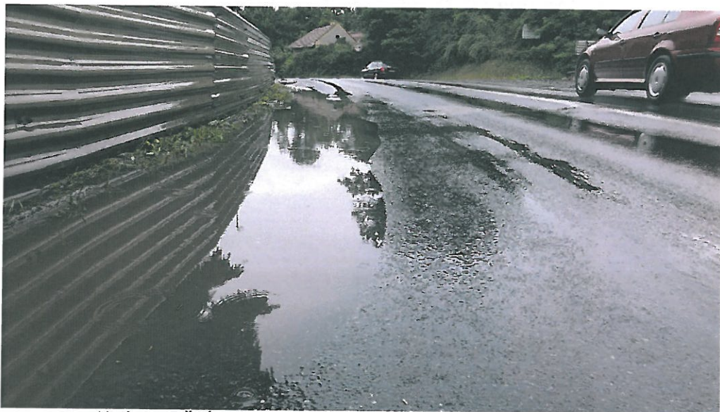
Nedostatečné nebo nefunkční odvodnění komunikace - příklad
